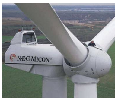
Photo n° 7 : Vue de la nacelle d'une éolienne On notera la présence d'une personne dans la nacelle !
